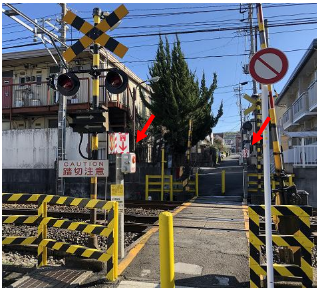
設置した押しボタン（七ツ新屋第1踏切道）
