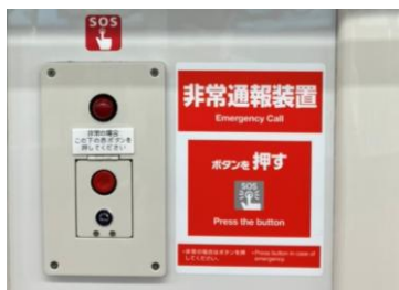
電車内「非常通報装置」
