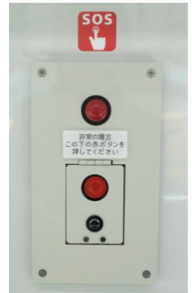
非常通報ボタン
