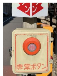
踏切「非常通報ボタン」
