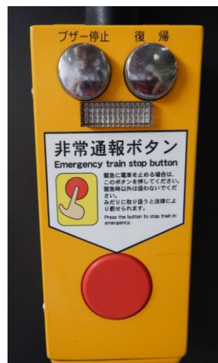
非常通報ボタン
