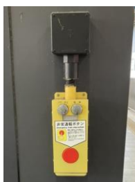
駅「非常通報ボタン」
