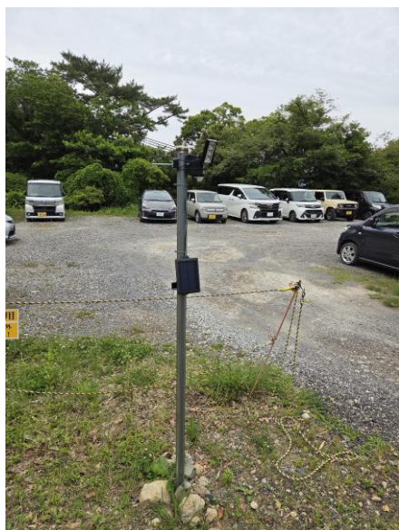
設置した外灯（昼間）
