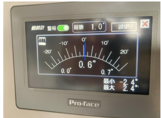
搬器内モニター部分 表示状態
